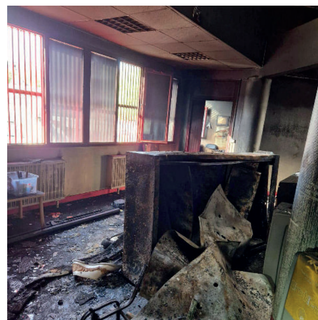
Destruction totale de la Maison de quartier-Centre social des Épinettes.
